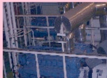
Un des générateurs électriques
